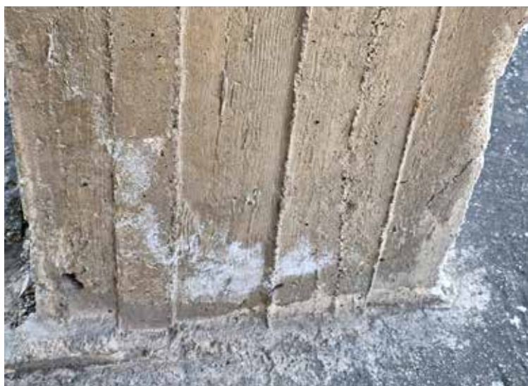
Εξανθήματα αλάτων, απόπληξη υδραβέστου και απώλεια αποθεματικής αλκαλικότητας σε υποστήλωμα κτιρίου Ο/Σ
