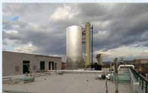
Μονάδα συνδυασμένης αναερόβιας—αερόβιας επεξεργασίας αποβλήτων ζυθοποιίας Heineken Σερβίας Οργ. φόρτιση 2.900 kgBOD 5 /d (44.000 ισοδύναμα άτομα)
