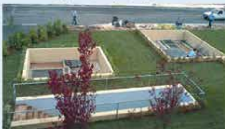
Υπεδάφια μονάδα MBR στο McArthur Glen, Σπάτα
