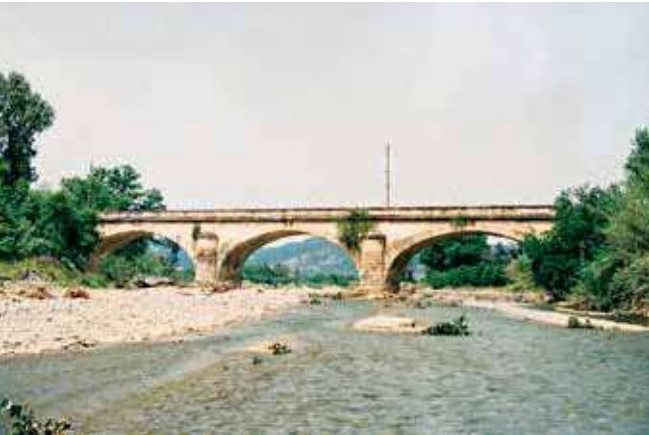
Η εντυπωσιακή γέφυρα του Κερίτη πριν και μετά την κατάρρευση
