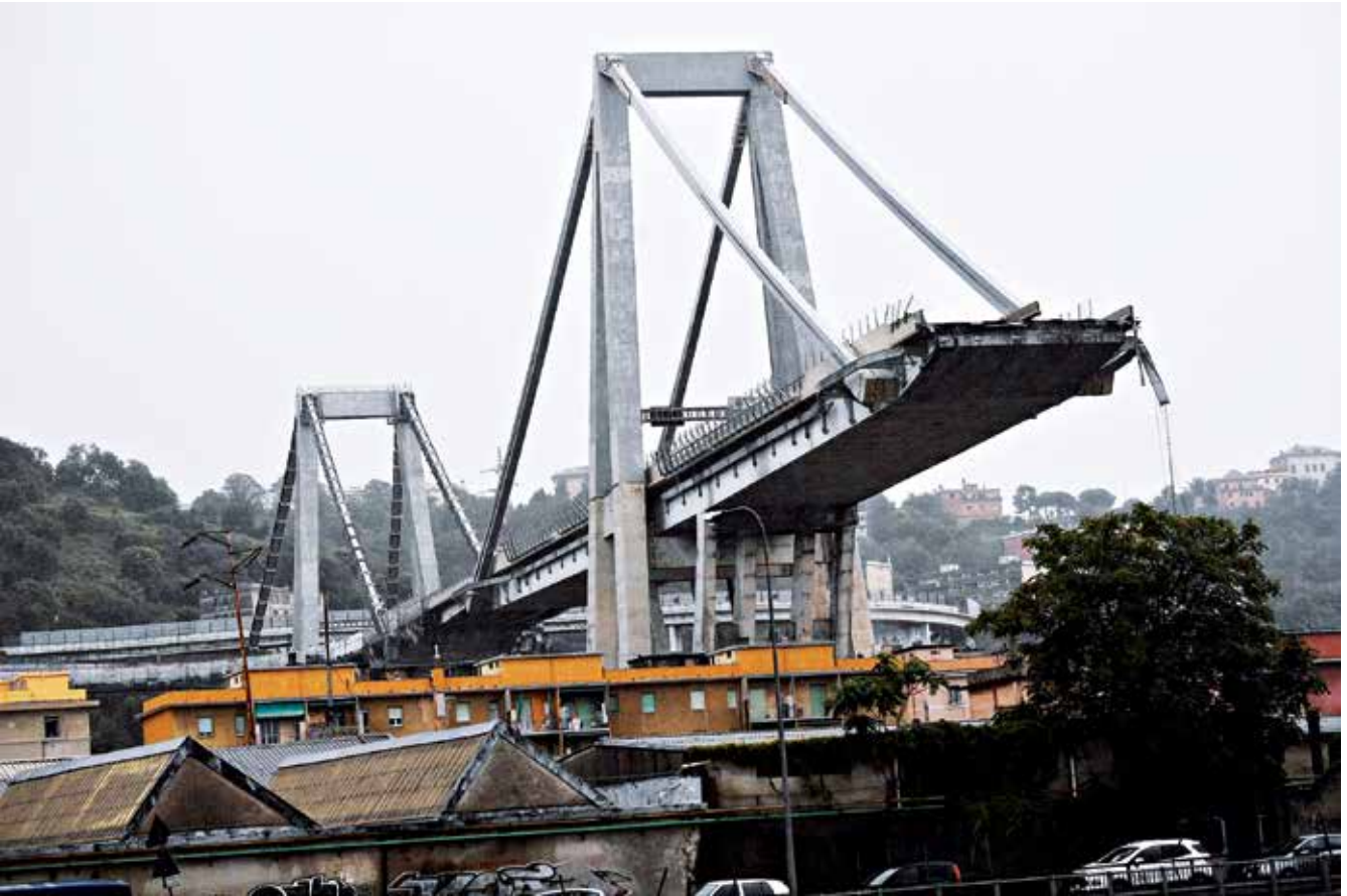
Φωτ. 1 Αστοχία στη γέφυρα της Γένοβας (Αύγουστος 2018)
