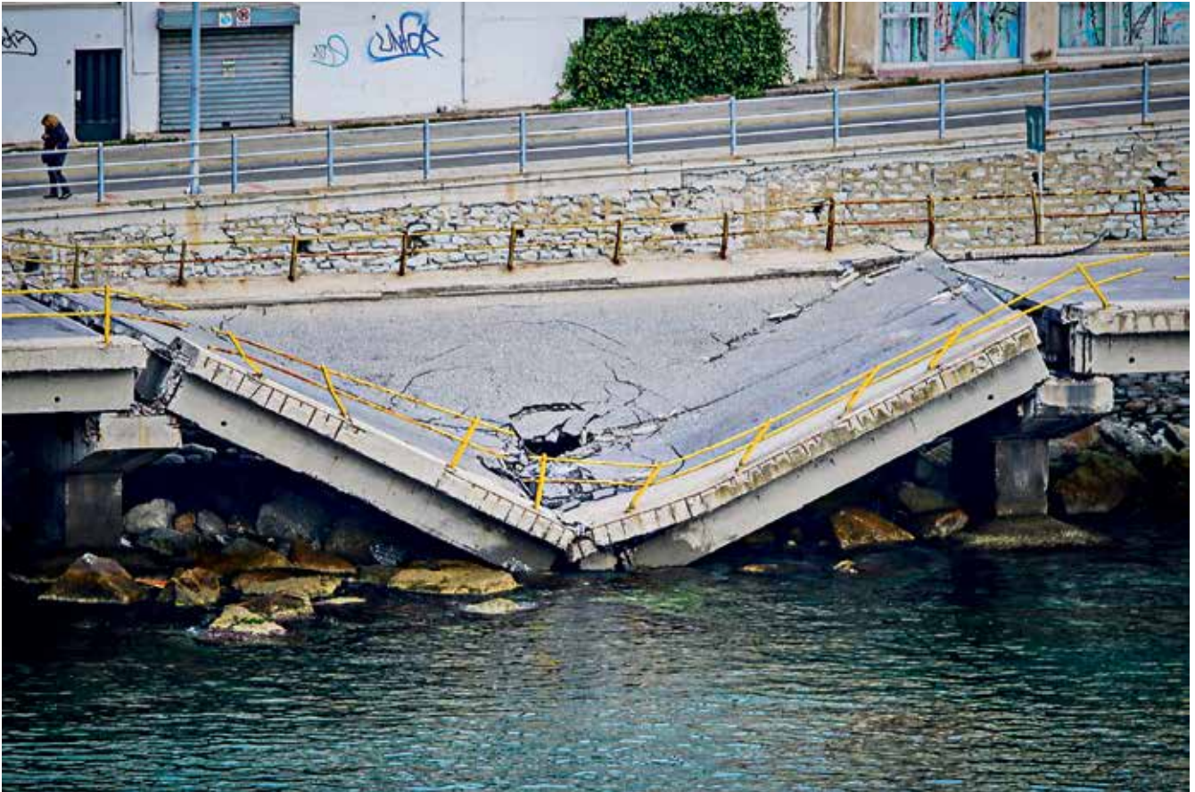
Φωτ. 2 Κατάρρευση τμήματος γέφυρας στην Καβάλα (Νοέμβριος 2018)
