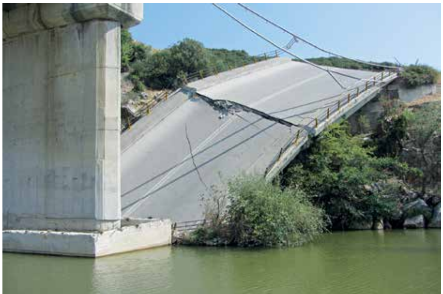
Γέφυρα Κομψάτου: Κατάρρευση ανατολικού ζυγώματος
