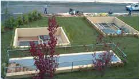
Υπεδάφια μονάδα MBR στο McArthur Glen, Σπάτα
