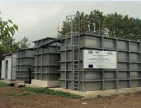
Compact μονάδα επεξεργασίας αστικών λυμάτων τεχνολογίας MBR της Κοιν. Στενιμάχου Νάουσας
